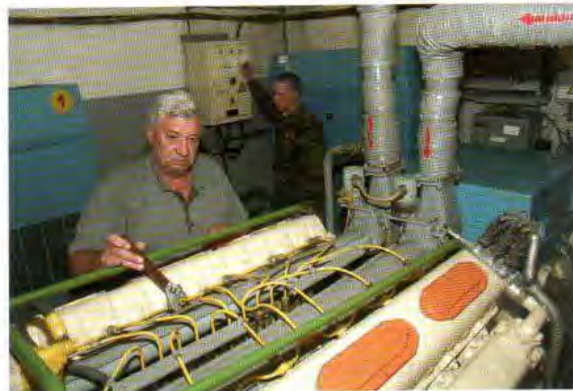
Начальник дежурной смены ЭПС Плоцин В.П. проводит обслуживание АСДА-200
