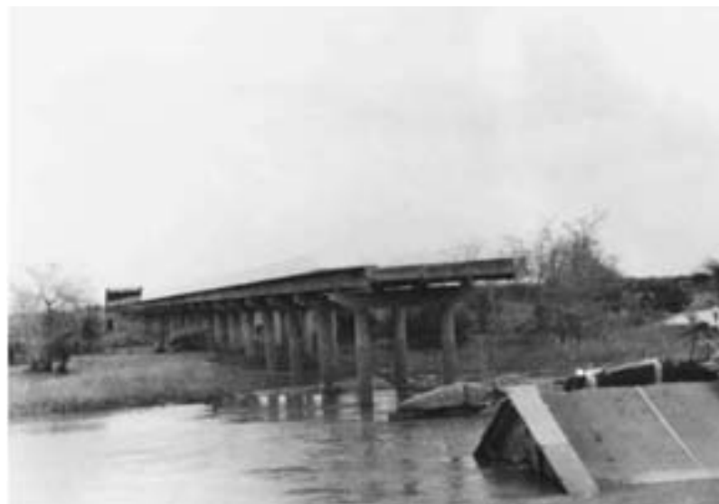
Взорванные пролёты 900-метрового моста через реку Кунене.
